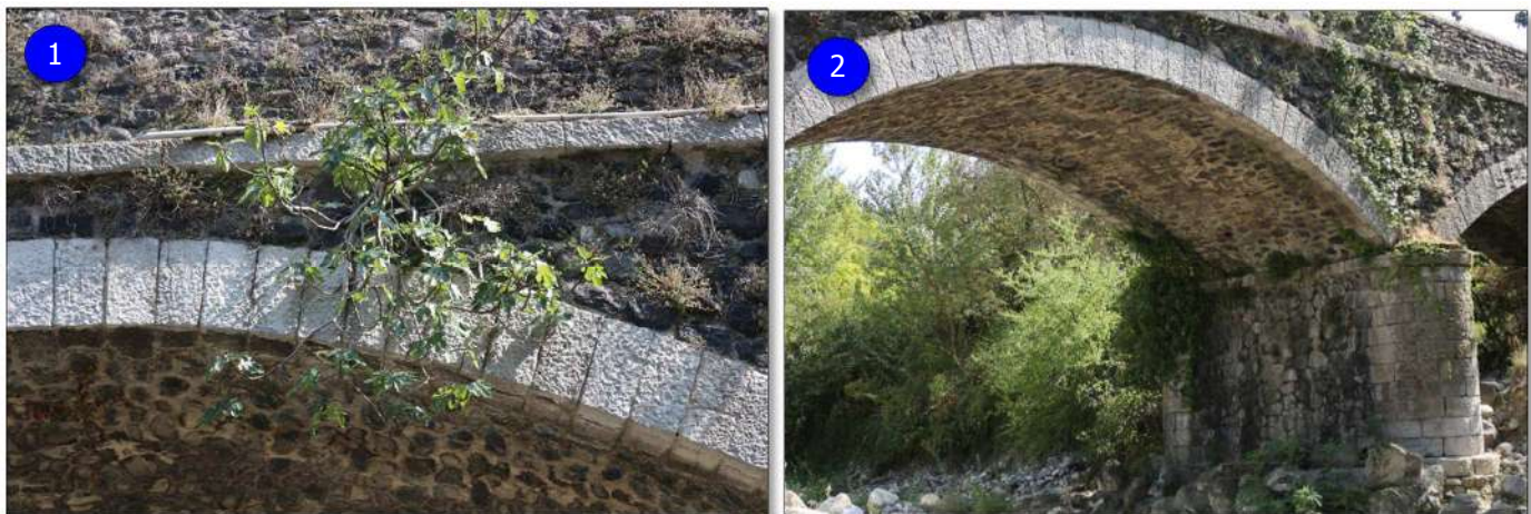
Figure 2 : (1) figuier poussant entre la plinthe et le bandeau, on note également la végétation sur le fût et le tympan ; (2) végétalisation sous la douelle de T2 notamment au niveau de la naissance. On note également les coulures sur le corps de pile.
