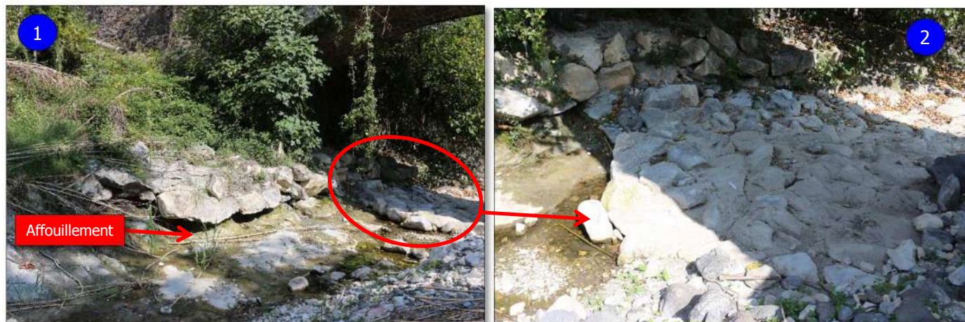
Figure 3 : (1) affouillement du massif de reprise de C0 ; (2) déstabilisation du radier sous T1 notamment. Notez également la végétation sur C0.
