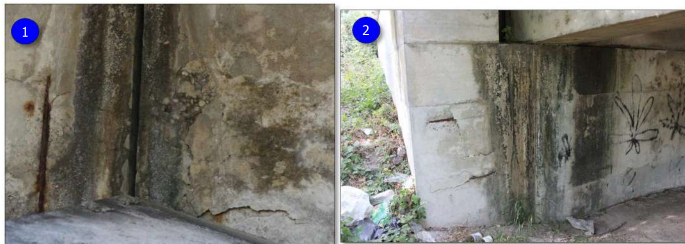
Figure 7 : (1) éclatement du béton, infiltrations d'eau et armatures apparentes au-dessus d'une pile ; (2) écoulements depuis le mur garde-grève de la culée C0, éclatement du béton avec armatures apparentes...
