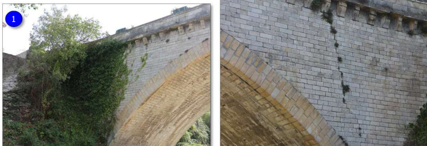
Figure 5 : (1) tympan aval rive gauche végétalisé ; (2) tympan aval rive droite fissuré et coulures sous la douelle
