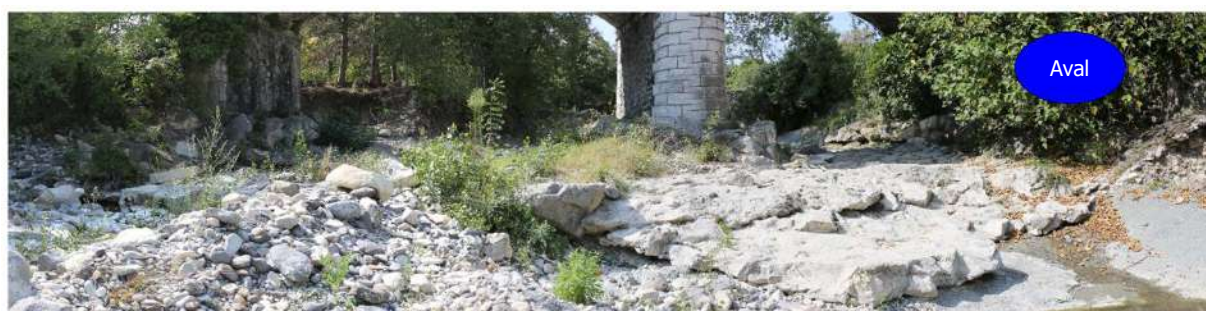
Figure 4 : état du radier parafouille encore visible notamment sous T1, vu depuis l'aval. Il est déstabilisé.
