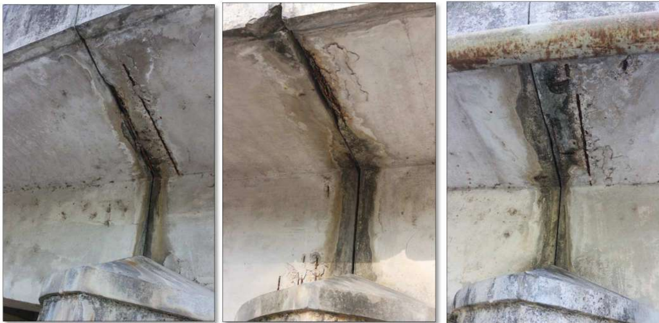
Figure 6 ; tous les abouts des dalles du tablier présentent des épaufrures et éclatement du béton avec armatures apparentes qui sont enrouillées. On note également des infiltrations d'eau. Ces trois photos sont des illustrations tous les abouts présentent des pathologies similaires.
