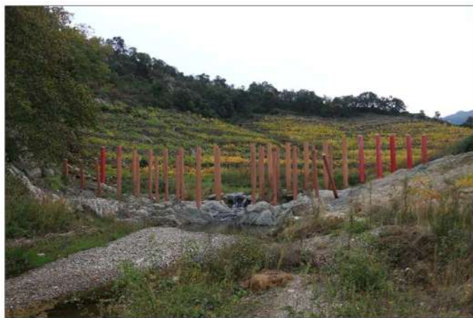
Figure 9 : piège à embâcles sur la Baillaury (Banyuls, 66)
