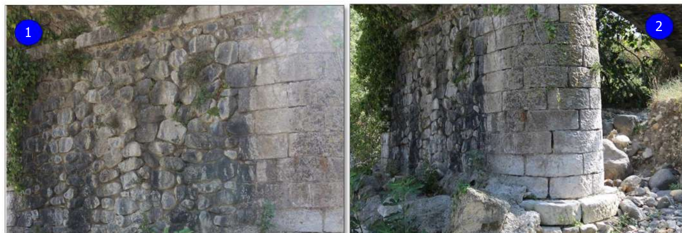
Figure 4 : disjointoiement de la maçonnerie (sans lacune) et coulures ; (1) sur le fût de P2, (2) sur l'avant-bec de P2, par endroit une pige rentre de plus de 10 cm.
