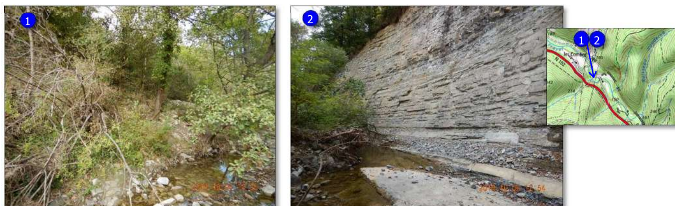
Figure 6 : (1) zone contrainte par la végétation favorisant les embâcles avec végétation pouvant être arrachée (2) zone de contraintes latérales favorisant les dépôts d'embâcle (avec méandrage et seuil à l'aval).
