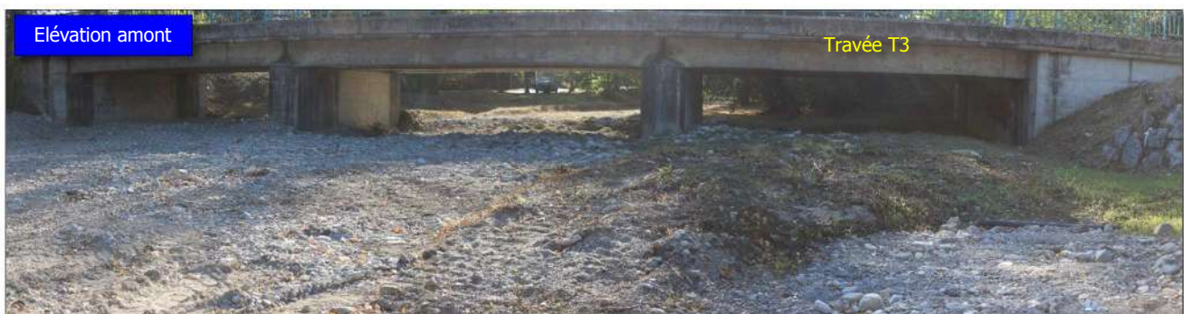
Figure 8 : pont ch. de Gaulle, la travée T3 n'est pas complètement libérée et le façonnage du lit aurait dû comporter un guidage pour que lors de la mise en eau post-assec le lit de basses eaux se fixe sous T2. Cette action est importante pour la cinématique de modification du lit lors des montées d'eau
