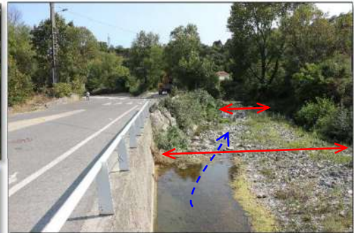
Figure 4 : Vue du rétrécissement positionné en aval du méandre du pont qui modifie les courants en crue
