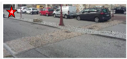
Traversée piétonne face à la rue Chèvrerie et à l'école peu lisible et non accessible, un choix de revêtement peu lisible sur cette traversée empruntée aux heures d'entrée/sortie de l'école (dépose des parents)
